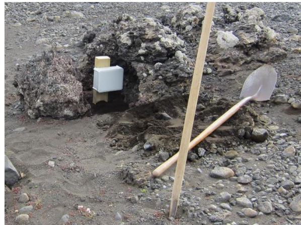
3. mynd. Bifreiðateljara komið fyrir í vegkanti.
